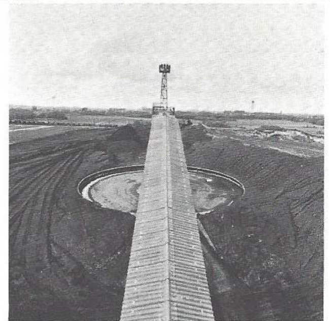
▲ Transporteur à charbon
